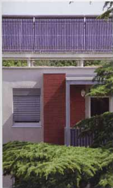
30 m 2 de capteurs sous vide sont implantés en terrasse sur l'immeuble nord, avec une orientation plein sud et une inclinaison de 45°.
